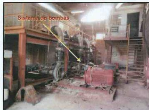
Fotografía N° 25: Dentro de la estación de bombeo Garacalzon, se observó un sistema de bombas a través del cual el agua ácida era bombeada hacia la laguna Yanamate..
