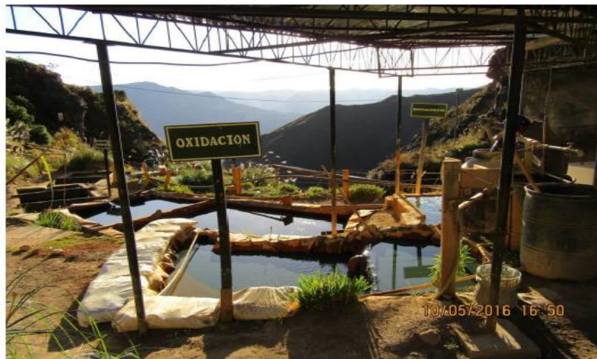
Fotografía N° 18: Sistema de tratamiento de agua de la zona de Azalia, ubicado en las coordenadas UTM WGS84 8841978N; 344778E. Se aprecia las pozas de oxidación del sistema.
