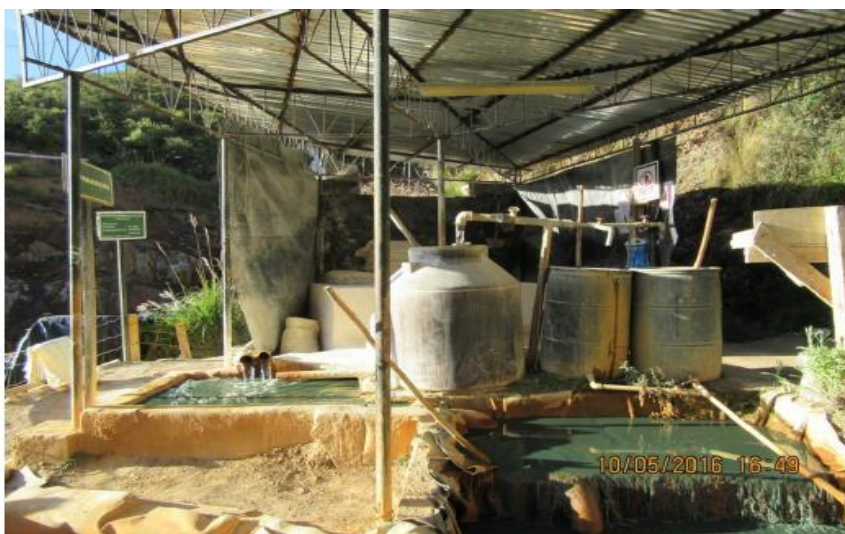
Fotografía N° 17: Sistema de tratamiento de agua de la zona de Azalia, ubicado en las coordenadas UTM WGS84 8841978N; 344778E. Se aprecia la zona de neutralización, inicio del sistema
