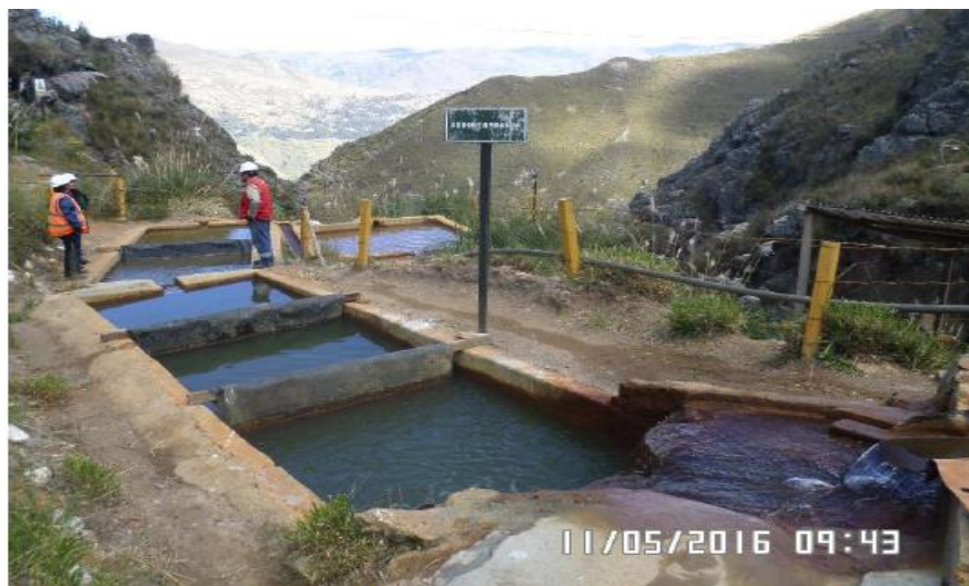
Fotografía N° 21: Sistema de tratamiento de agua de la zona de Azalia, ubicado en las coordenadas UTM WGS84 8841978N; 344778E. Se aprecia el letrero de identificación de las pozas de sedimentación del sistema.
