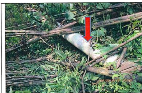
Fotografía N° 8. Punto de falla donde se originó el derrame – Km 53+939. Línea B de 10” Corrientes - Saramuro colocado sobre el terreno firme, rodeado de vegetación. Se verifica tubería reparada (reemplazo). A nivel superficial no se advierte presencia de hidrocarburos sobre el derecho de vía. Coordenadas UTM (WGS84): 9528003 N / 493775 E.
