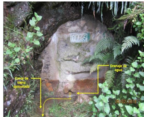
Fotografía N° 434: Bocamina BCJ-65. Ubicada en el Sector 9: Mina Cerro Jesús, con coordenadas UTM WGS 84 - Zona 17: N 9252620; E 763952, donde se observa un muro de mampostería y el drenaje de agua por la base del muro, éste flujo es direccionado por un canal en tierra apisonada.
