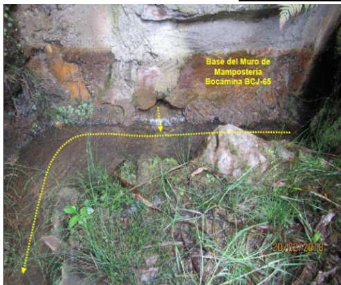
Fotografía N° 435: Vista de la base de la Bocamina BCJ-65. Ubicada en el Sector 9: Mina Cerro Jesús, donde se observa drenaje de agua por la base del muro de mampostería, éste flujo es direccionado por un canal en tierra apisonada.
