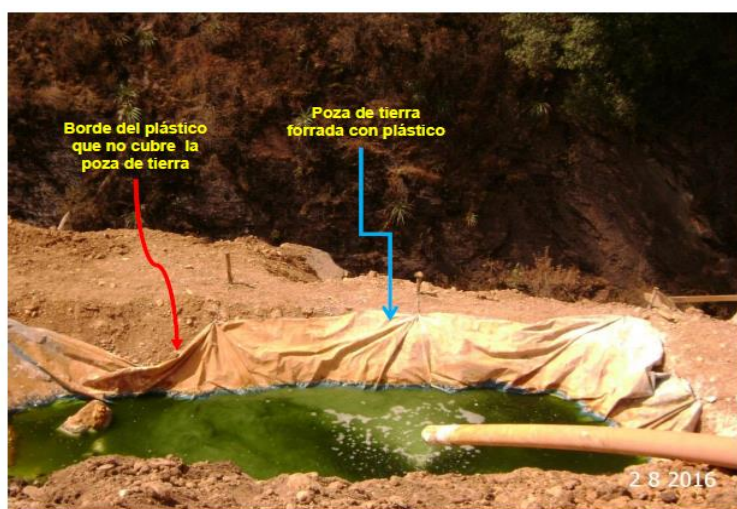
Fotografía N° 44: Otra vista de la poza de tierra forrada con plástico, donde se colecta el subdrenaje de la relavera Vista Bella. Se observa que el borde del forro no cubre totalmente esta poza.
