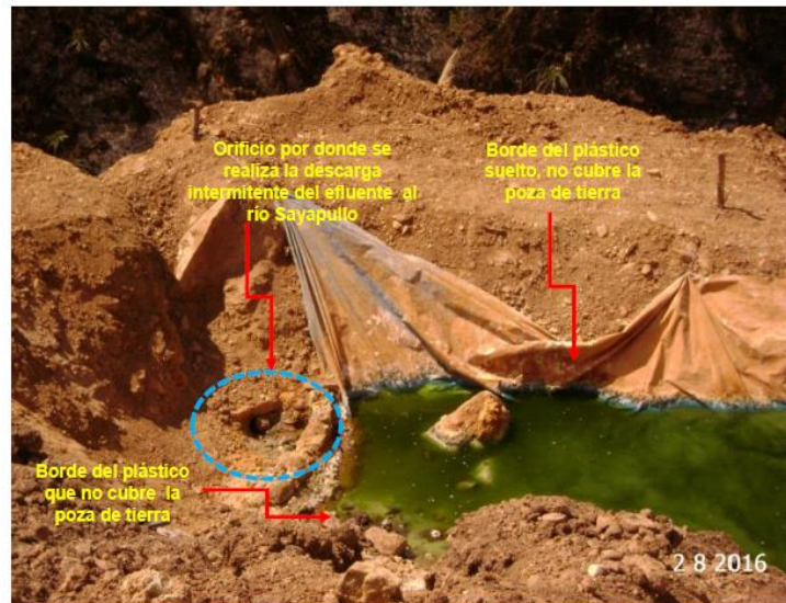
Fotografía N° 45: Vista de un sector de la poza, donde el forro no cubre totalmente la poza de tierra, observándose que el efluente tiene contacto con el suelo. Además se observa el orificio por donde se realiza la descarga intermitente del efluente hacia el río Sayapullo.
