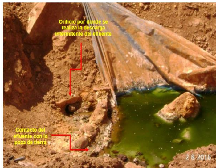
Fotografía N° 46: Vista cercana de un sector de la poza de tierra, donde el forro no cubre totalmente la poza, observándose que el efluente tiene contacto con el suelo. Además se observa el orificio por donde se realiza la descarga intermitente del efluente.
