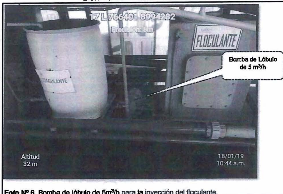
Foto N° 6. Bomba de lóbulos de 5m 3 /h para la inyección del floculante.
