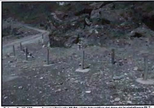
Fotografía N° 120: Incumplimiento N° 01: Vista fotográfica del área de la plataforma PLT-23, donde se observó que el área de la plataforma se encontraba formando parte del acceso, se verificó ocho sondejos.
