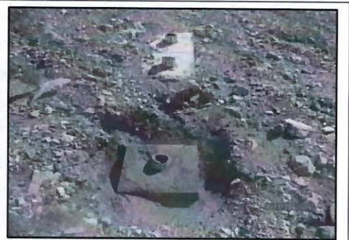
Fotografía N° 158: Vista fotográfica de la Plataforma de Perforación PLT-20, donde se observó los sondajes con código AT 112, AT 113 y AT 114; los cuales presentaba un bloque de concreto y una tubería de PVC.
