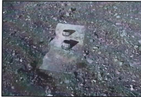
Fotografía N° 157: Incumplimiento N° 01: Vista fotográfica de la Plataforma de Perforación PLT-20, donde se observó los sondajes con código AT 116 y AT 115; los cuales presentaba un bloque de concreto y una tubería de PVC.
