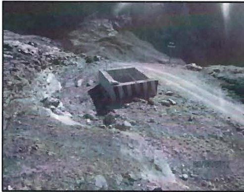
Fotografía N° 140: Incumplimiento N° 03: Vista fotográfica del área de la chimenea VR-1100, donde se observó el corte del talud realizado en el terreno, se verificó la construcción de una chimenea en la cota 4496.
