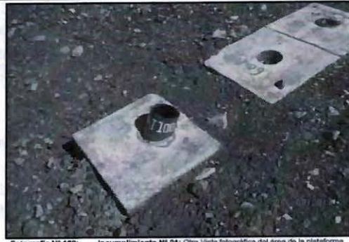
Fotografía N° 132: Incumplimiento N° 01: Otra Vista fotográfica del área de la plataforma PLT-22, donde se observa tres sondejos de los diez verificados, dichos sondejos no presentaban afloramiento de agua.
