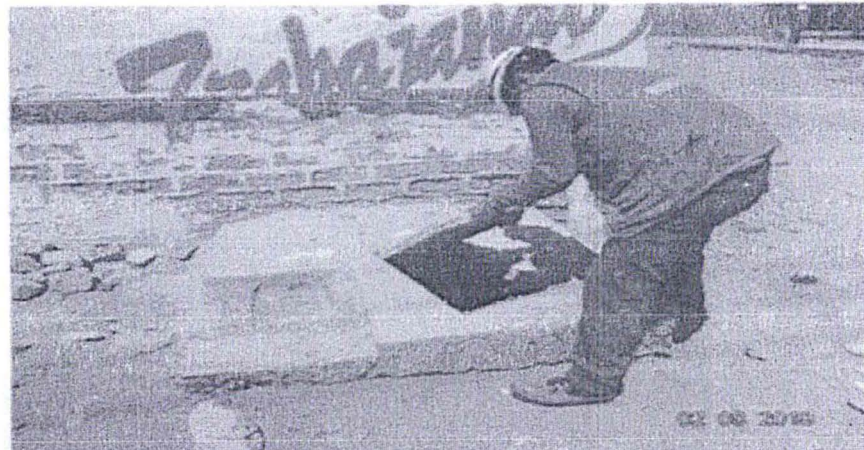
Foto N° 10.- Ubicación del Buzón de desagüe del EIP PESQUERA GAMMA SA. - PLANTA CHIMBOTE (Avenida Meiggs).
