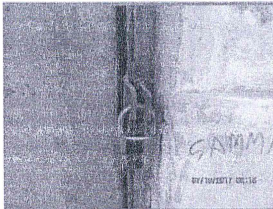
Foto N° 26: Candado colocado por la parte externa de la puerta de ingreso a la unidad fiscalizable ubicada en el Pasaje Santa Rosa s/n, con la finalidad de indicar que esta puerta no es usada.
