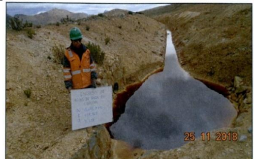
Foto 2.8. Vista mostrando la poza de captación de las aguas de contacto previo al ingreso al sistema de tratamiento. Las aguas captadas en esta zona provienen de los lados sur y norte del BMI. Se tiene las coordenadas siguientes: N 8°611,375 y E 437,167.
