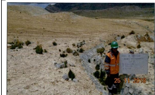
Foto 2.7. Vista mostrando el inicio del canal de captación de aguas de contacto del BMI, el cual se encuentra ubicado en el lado norte del BMI. Se tiene las coordenadas siguientes: N 8°611,598 y E 437,283.
