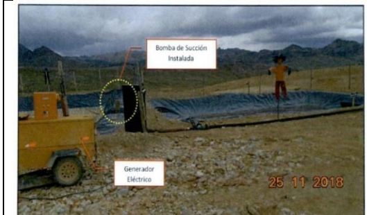
Foto 2.5. Vista de la Poza de Subdrenaje de la Ampliación del BMI, las aguas captadas también son derivadas a la poza de tratamiento. Asimismo, se aprecia el generador eléctrico y la bomba de agua que sirven para enviar el agua a la Poza de Tratamiento del BMI.
