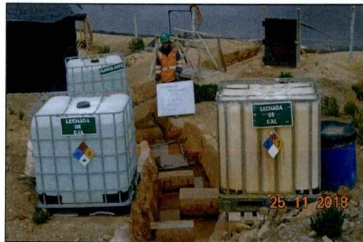
Foto 2.9. Vista mostrando el sistema de tratamiento implementado para las aguas de contacto provenientes del BMI y de la Cantera Willy II. Las aguas tratadas son dosificadas con lechada de cal y posteriormente se aplica floculante para sedimentar las partículas generadas. Se tiene las coordenadas siguientes: N 8'611,372 y E 437,148.
