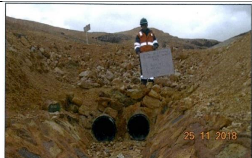
Foto 2.2. Vista mostrando el inicio del canal de captación de aguas de contacto del BMI así como las tuberías que facilitan el ingreso de las aguas de contacto provenientes de la Cantera Willy II. Se tiene las coordenadas siguientes: N 8°610,983 y E 437,452.
