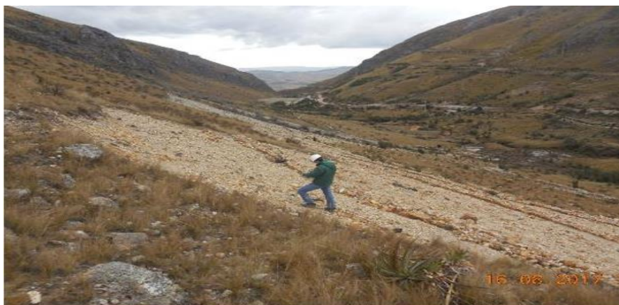
Fotografía N° 30. Vista del área de la plataforma PL-YAN-KUP09-007, la cual se encontraba perfilada de acuerdo con el entorno topográfico del lugar, pero no contaba con vegetación, ni dado de concreto. No se observó afloramiento de agua en la plataforma mencionada. (Coordenadas UTM WGS 84 Zona 17 E 775 167 N 9 225 346).
