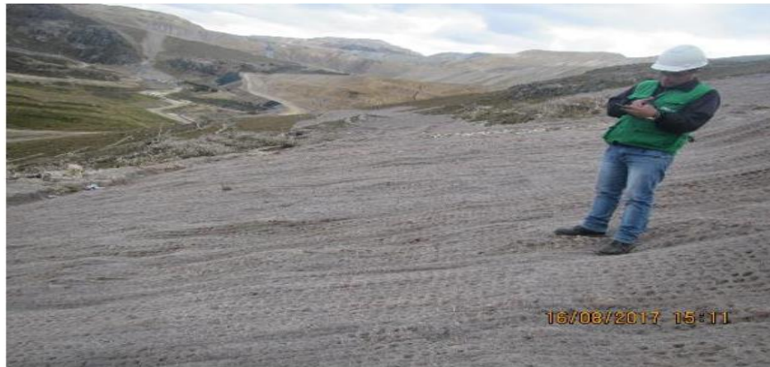
Fotografía N° 50. Vista del área de la plataforma PL-YAN-12-363, la cual no presentaba dado de concreto. El área de dicha plataforma se encontraba perfilada de acuerdo al entorno topográfico del lugar, y el talud se encontraba revestido con biomanta de fibra de coco, no se observó indicios de revegetación. Presentaba un canal de coronación en la parte superior del talud. Coordenadas UTM WGS 84 Zona 17 E 775 515 N 9 225 469. Presentaba un muro de contención en la parte superior e inferior del talud, también contaba con un canal de enrocado en forma de media luna.
