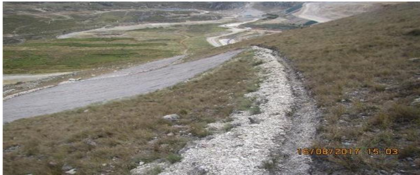
Fotografía N° 49. Vista del área de la plataforma PL-YAN-12-339, la cual no presentaba dado de concreto. El área de dicha plataforma se encontraba perfilada de acuerdo al entorno topográfico del lugar, el talud se encontraba revestido con biomanta de fibra de coco, pero no se observó indicios de revegetación. Presentaba un canal de coronación en la parte superior del talud. Coordenadas UTM WGS 84 Zona 17 E 775 625 N 9 225 606. Presentaba un muro de contención en la parte superior e inferior del talud, también contaba con un canal de enrocado en forma de media luna.
