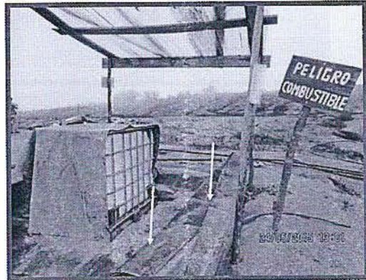
Fotografía N° 20: Se observa que el área de combustible, donde se encuentra el tanque de almacenamiento, se encuentra cubierta con geomembrana y cubierto por un techo de plástico.
