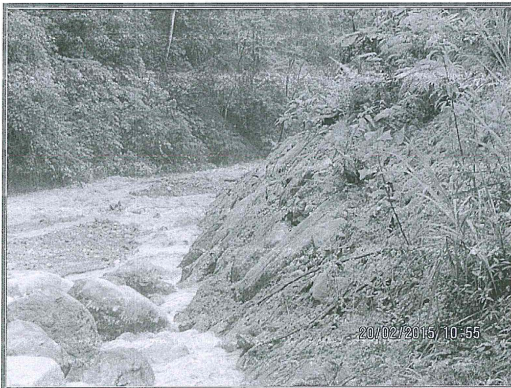
Fotografía N° 43: Se observa huellas de deslizamiento de relave hacia el cauce del río Puntayacu debido a la falta de enrocado de defensa ribereña en el talud de la relavera R1 y R2.
