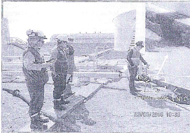
FOTO N° 05: VISTA PÁNORAMICA DEL HUMEDECIMIENTO EN EL ANILLO DE CIMENTACIÓN DEL TANQUE N° 14: Donde se visualiza al Supervisor de operaciones de Terminal Chimbote señalando el punto de fuga del Diésel B5.
