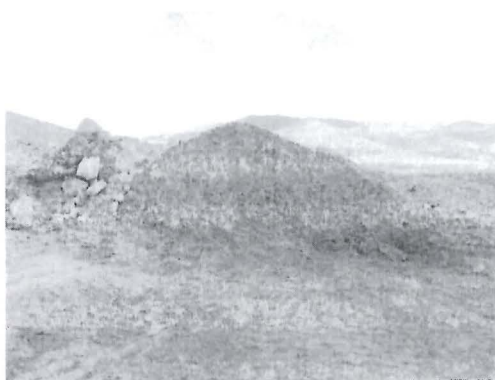
Fotografía N° 141: Hallazgo N° 01, Top soil depositado en la zona del botadero de material excedente de la curva Cumani, notándose que aparentemente el desbroce se ha realizado correctamente.
