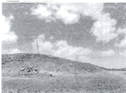
Fotografía N° 105: Hallazgo N°02 y Hallazgo N° 03, Lado oeste del depósito de desmonte de material excedente. se observa que la cobertura vegetal en esta zona se encuentra cubierta por sedimento. Del mismo modo nótese la falta de infraestructura hidráulica.
