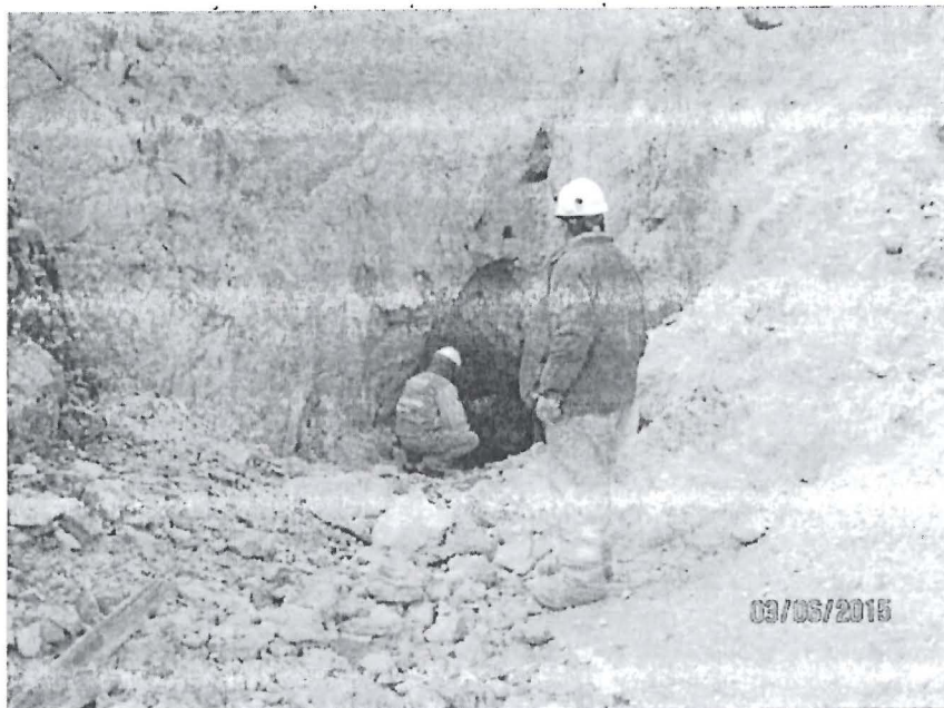
Fotografía N° 10: Bocamina pendiente de cierre ubicada en las coordenadas UTM WGS 84 N 8918707 y E 226355.
