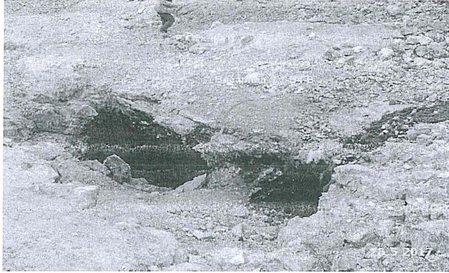
Fotografía N° 37: Vista de la bocamina L1-B4-B, ubicada en coordenadas UTM (WGS 84), E: 222289 N: 8923226, se encuentra abierta por un sector y con fragmentos de roca por sus alrededores. No presenta drenaje.
