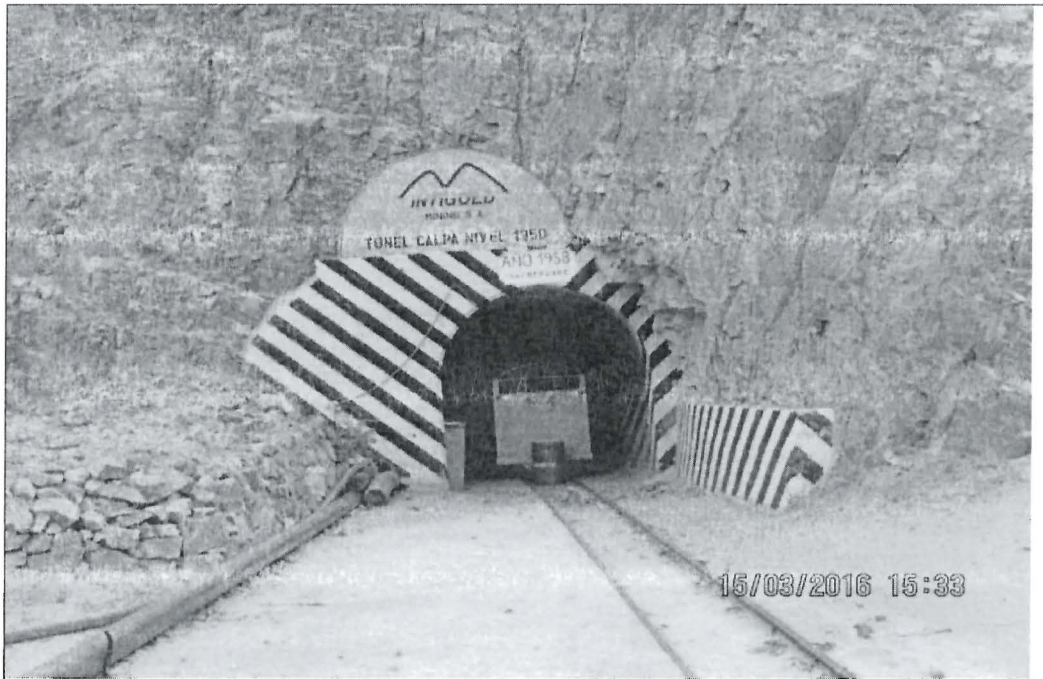
Fotografía N° 27 Vista cercana de la bocamina 1950 (Túnel Calpa) : Cuenta con un marco de concreto, no se observó salida de agua desde su interior.
