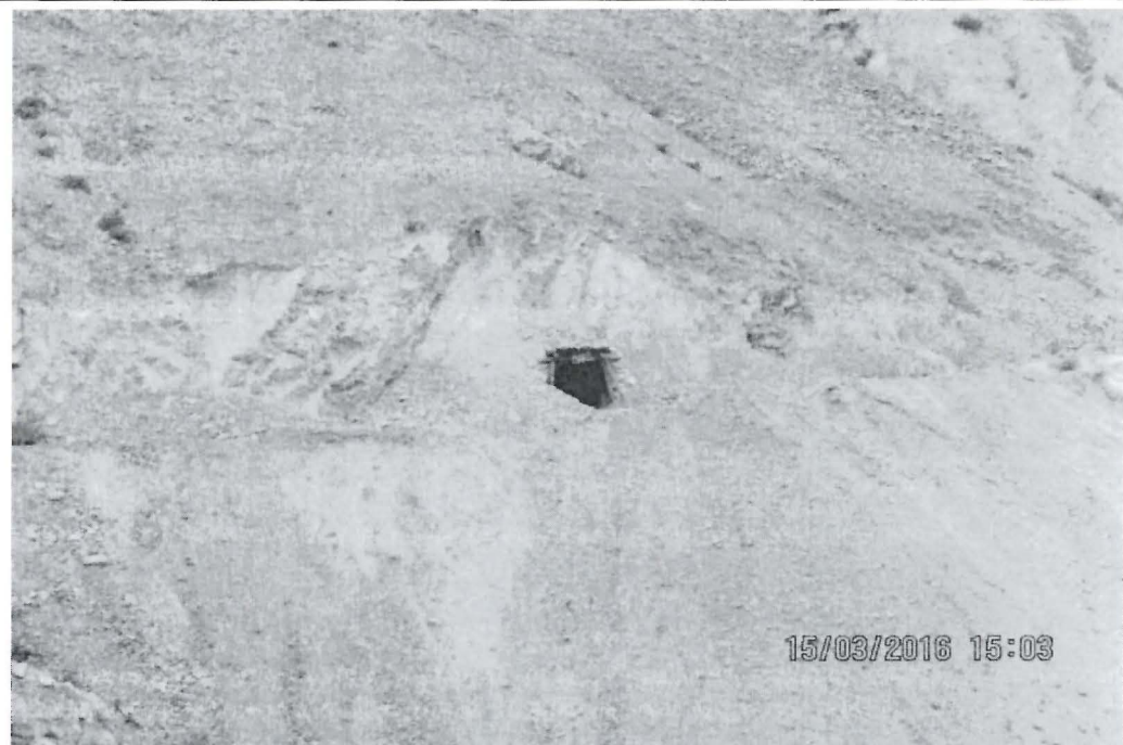
Fotografía N° 18 Bocamina B-79 (Nivel 2184) : Vista panorámica, se observó abierta y no se realizaban actividades durante la supervisión. No se observó que se tenga implementado cerco de alambre con columna de madera, tampoco se observó zanjas de coronación. Forma parte del presunto incumplimiento N° 1.
