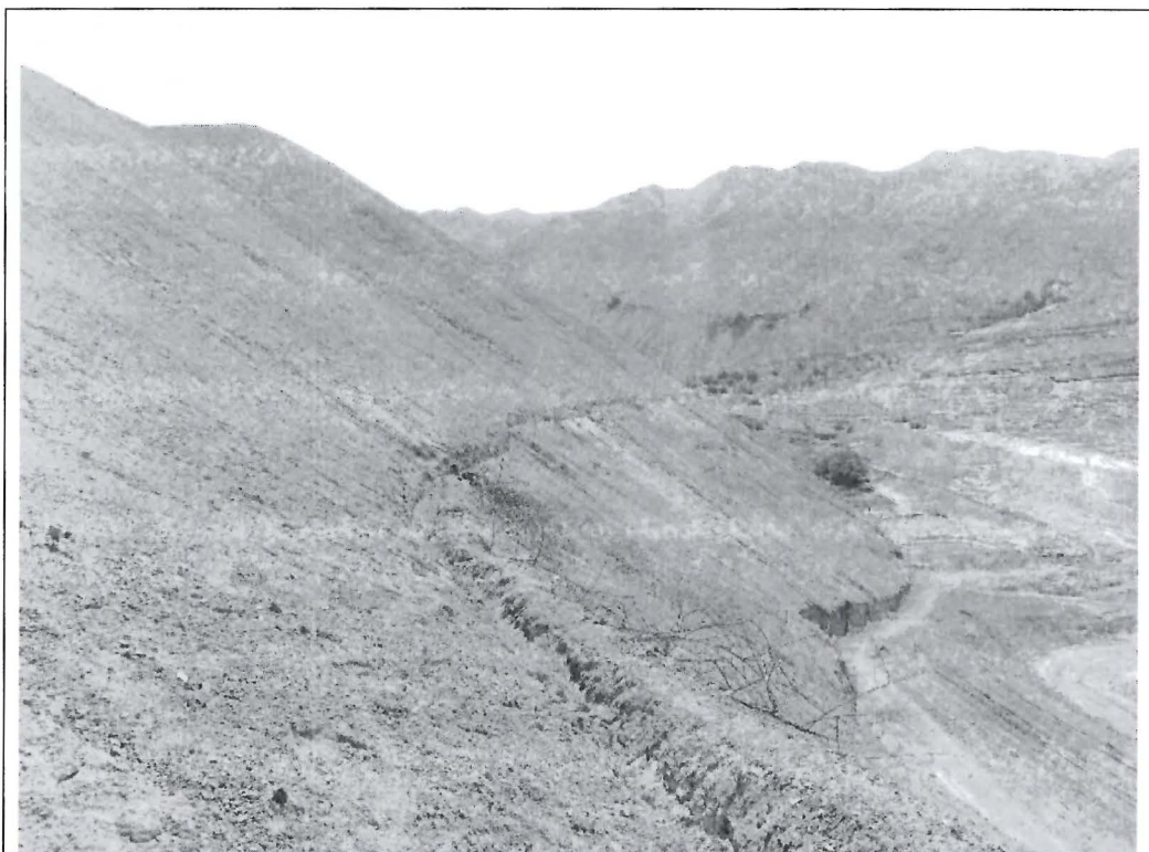
Fotografía N° 41. Hacia el extremo izquierdo del depósito de relaves de flotación existía un canal habilitado sobre suelo, que direccionaría el agua hacia dicho depósito. Forma parte del presunto incumplimiento N° 2.
