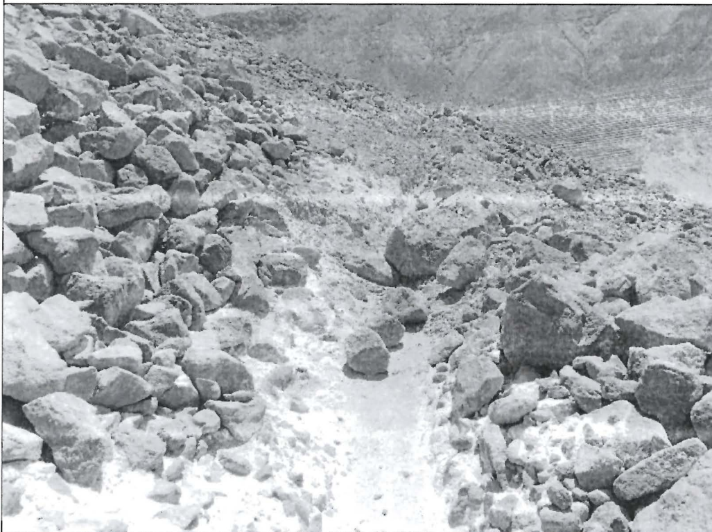
Fotografía N° 44. En el depósito de relaves de flotación, en el tramo que no se cuenta con canal de concreto se observó un canal habilitado sobre el suelo, el cual se encontraba colmatado en algunos tramos, este no derivaría el agua de lluvia proveniente de la partes altas. Forma parte del presunto incumplimiento N° 2.
