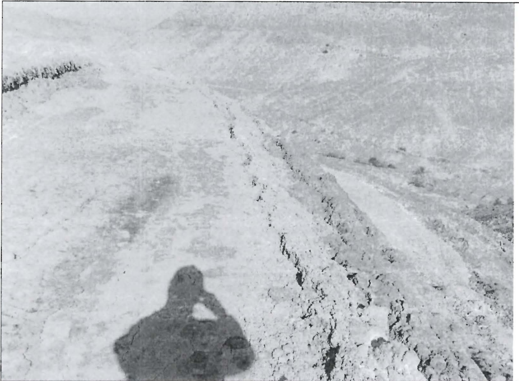
Fotografía N° 54. El depósito de relaves de cianuración presenta grietas en el talud, las que se habrían generado a raíz del deslizamiento de este, por tanto no se estaría realizando la estabilización en zonas inseguras. Forma parte del presunto incumplimiento N° 2.
