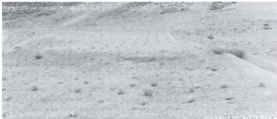
Fotografía N° 157: Hallazgo N°5: Se observó crecimiento de vegetación característica de la zona, creciendo al interior del canal de coronación de la escombrera E-10.
