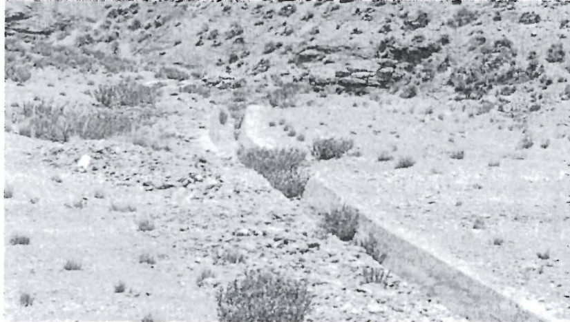
Fotografía N° 159: Hallazgo N°5: Se observó crecimiento de vegetación característica de la zona, creciendo al interior del canal de coronación de la escombrera E-10.
