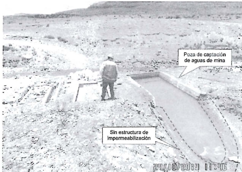
Fotografía N° 5. Vista fotográfica de la poza que capta las aguas de mina que afloran del interior de la bocamina, uno de sus extremos se encuentran sin estructura de impermeabilización. Este hecho fue establecido como hallazgo
