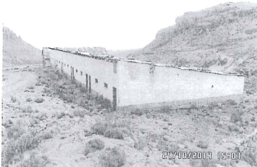
Fotografía N° 36. Hallazgo N° 01. En la zona con coordenadas Datum UTM WGS 84 N: 8545606, E: 490569, se observó dos ambientes de concreto con techo de calamina.
