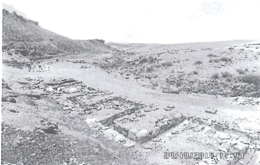
Fotografía N° 6. Vista fotográfica de las obras para la construcción del canal de aireación tipo serpentín, el cual se conecta con la poza de captación de aguas de mina para la bocamina B-10.
