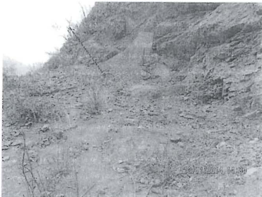
Fotografía N° 38: Hallazgo N° 1, Supervisión Regular noviembre 2014, otra vista de la plataforma de perforación Quin-2 (Q-2) ejecutada con letrero de identificación, que se encuentra sin cierre. Se observa el talud expuesto y la falta de perfilado.
