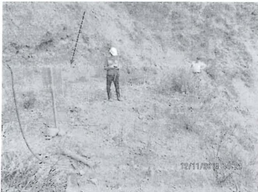
Fotografía N° 36: Hallazgo N° 1, Supervisión Regular noviembre 2014, otra vista de la plataforma de perforación Quin-1 (Q-1) ejecutada con letrero de identificación, que se encuentra sin cierre. Se observa el talud expuesto y la falta de perfilado.
