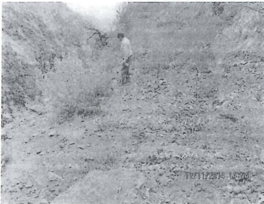
Fotografía N° 43: Hallazgo N° 1, Supervisión Regular noviembre 2014, vista de la plataforma de perforación Quin-4 (Q-4) ejecutada con letrero de identificación, que se encuentra sin cierre. Se observa el talud expuesto y la falta de perfilado.
