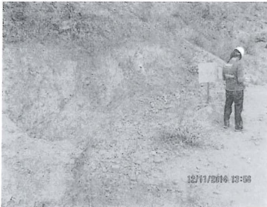
Fotografía N° 34: Hallazgo N° 1, Supervisión Regular noviembre 2014, vista del área de la plataforma de perforación Quin-6A (Q-6A) ejecutada, con letrero de identificación y que se encuentra sin cierre. Se observa también el talud expuesto y material disgregado sobre el suelo.
