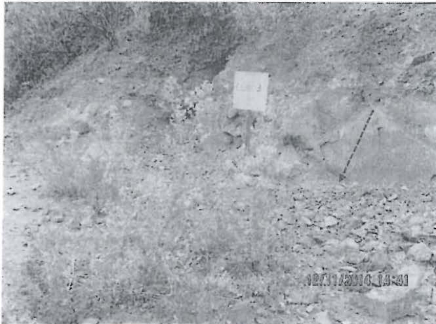
Fotografía N° 41: Hallazgo N° 1, Supervisión Regular noviembre 2014, otra vista de la plataforma de perforación Quin-3 (Q-3) ejecutada con letrero de identificación, que se encuentra sin cierre. Se observa el talud expuesto y material disgregado sobre el suelo.
