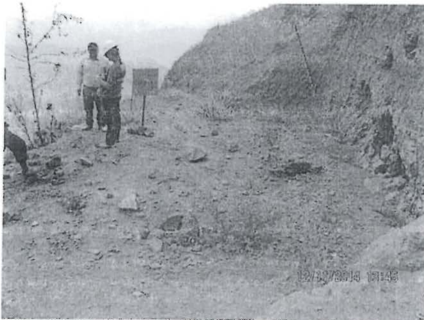
Fotografía N° 32: Hallazgo N° 1, Supervisión Regular noviembre 2014, vista de la plataforma de perforación Quin-6 (Q-6) ejecutada con letrero de identificación, que se encuentra sin cierre. Se observa el talud expuesto y la falta de perfilado.
