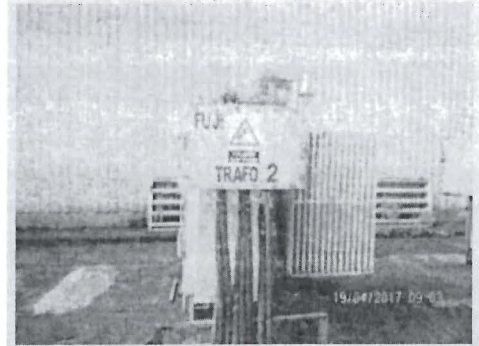
FOTO N° 16: LOTE 8 – PAVAYACU CENTRAL DE ENERGIA 130. Se observa el Transformador 2 que recibe la energía generada del grupo electrógeno Fuji ubicado en los exteriores del recinto de calamina de la Central de Energía 130 y no se observa evidencia de actividades de movimiento de materiales ni montaje ni instalación de los sistemas reductores de NOx ni sistemas electrostáticos para dicho generador de energía.
