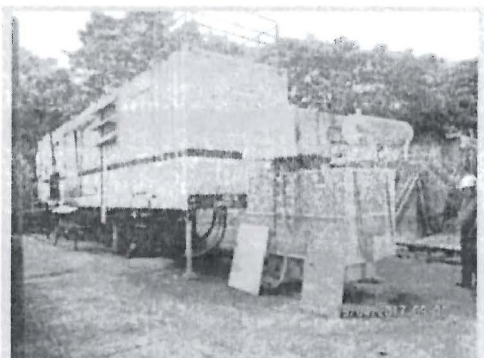
FOTO N° 20: LOTE 8 – PAVAYACU CENTRAL DE ENERGIA 130. Se observa el transformador y el generador de energía GE-153 ubicado en los exteriores del recinto de calamina de la Central de Energía 130 y no se observa evidencia de actividades de movimiento de materiales ni montaje ni instalación de los sistemas reductores de NOx ni sistemas electrostáticos para dicho generador de energía.
