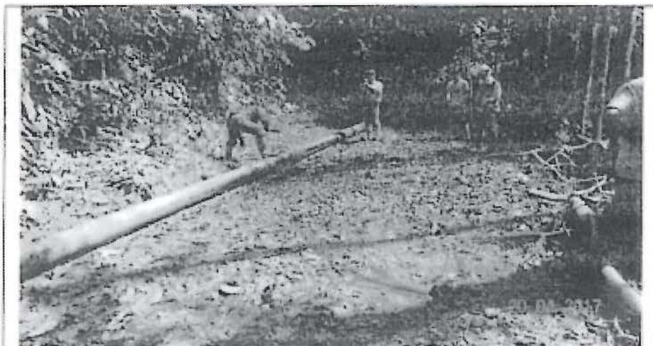
Foto N° 3. Tubería de 8" tendida sobre el suelo. Los alrededores del punto de derrame se encuentran con manchas de hidrocarburos en un área de 28 m 2 , por la posible fuga de hidrocarburos desde la grapa de seguridad. Se tomó muestras de suelo. Coordenadas UTM – WGS 84 Zona 18M: 427195E, 9638539N.
