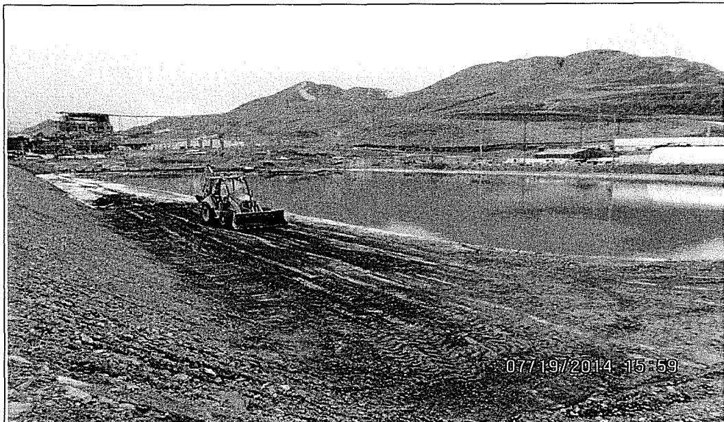
Fotografía N° 19: Vista de un cargador frontal realizando trabajos de recuperación del relave que se rebalsó de la poza de emergencia.
