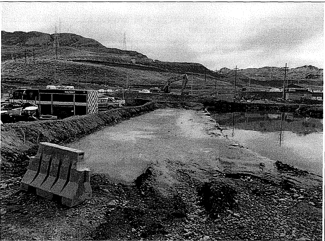
Fotografía N° 18: Otra vista de la poza de emergencia que presenta relave en la parte exterior.
