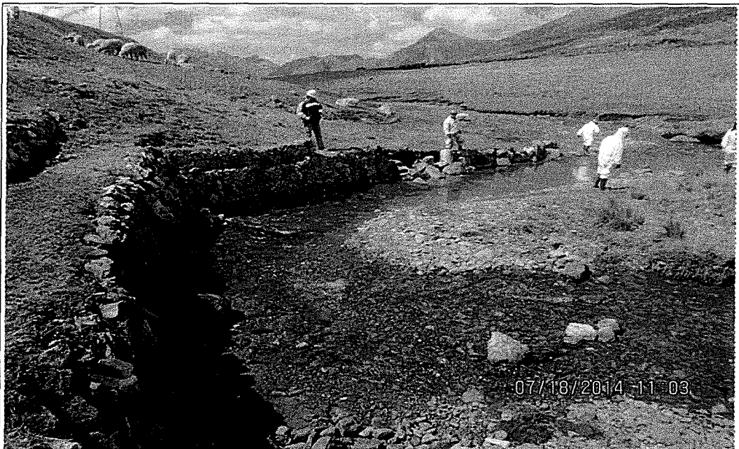
Fotografía N° 21: Vista de personal del titular minero realizando trabajos de limpieza en el río Rumichaca.
