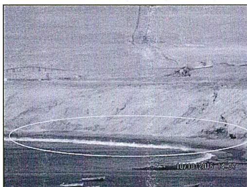
Fotografía N° 37. Zona de filtraciones ubicada al lado oeste de la Relavera Pampa Choclón. Se ubica en el acantilado adyacente al mar teniendo una dimensión aproximada de 700m. COORDENADAS UTM WGS84: 8313525N, 476204E. ZONA 18. Hallazgo N° 1.
