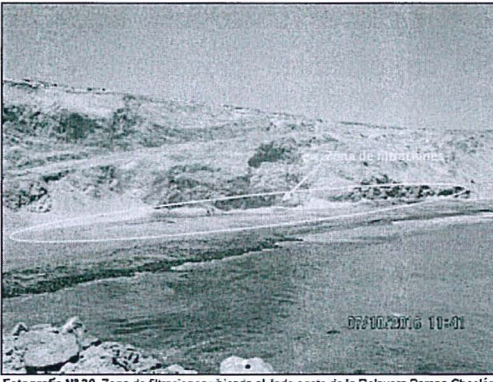
Fotografía N° 30. Zona de filtraciones ubicada al lado oeste de la Relavera Pampa Chocón. Se ubica en el acantilado adyacente al mar teniendo una dimensión aproximada de 700m. COORDENADAS UTM WGS84: 8313525N, 476204E. ZONA 18. Hallazgo N° 1.
