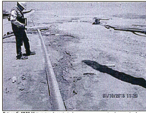
Fotografía N° 26. Vista rastros de corriente de agua que se encuentran ingresando a la poza de agua. COORDENADAS UTM WGS84: 8313792N, 477324E. ZONA 18. Hallazgo N° 3.
