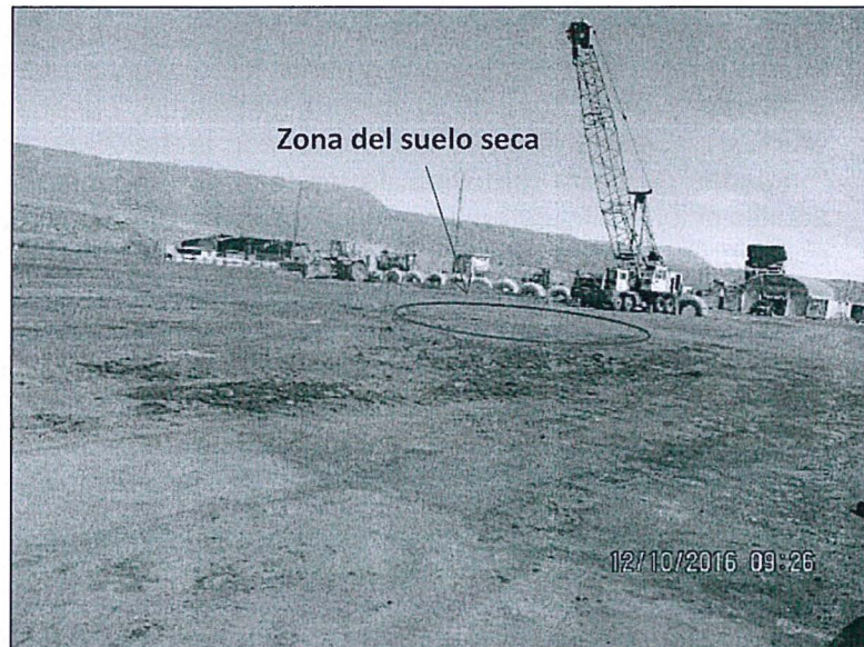
Fotografía N° 195. Instalaciones del Taller de reparación mayor y ensamblaje ubicado en el área de mina, en la imagen se puede observar la acumulación de lodo sobre el suelo de las instalaciones. COORDENADAS UTM WGS84: 8319105N, 486511E. ZONA 18.
