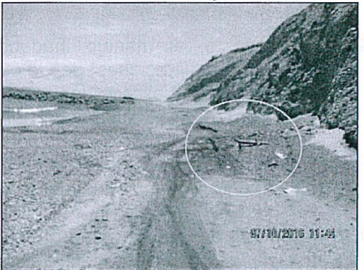
Fotografía N° 31. Zona de filtraciones ubicada al lado oeste de la Relavera Pampa Chocón. en la imagen se observa una de las tuberías encargada de captar las filtraciones. COORDENADAS UTM WGS84: 8313438N, 476179E. ZONA 18. Hallazgo N° 1.
