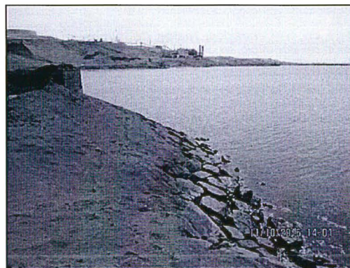
Fotografía N° 142. En la imagen se observa el Gantry, en el talud se puede observar la acumulación de polvo de mineral en contacto con el mar. COORDENADAS UTM WGS84: 8313402N, 474025E. ZONA 18. Hallazgo N° 4, ítem iii).
