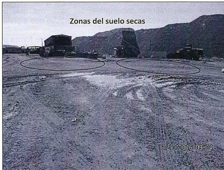
Fotografía N° 194. Instalaciones del Taller de reparación mayor y ensamblaje ubicado en el área de mina, en la imagen se puede observar la acumulación de lodo sobre el suelo de las instalaciones. COORDENADAS UTM WGS84: 8319105N, 486511E. ZONA 18
