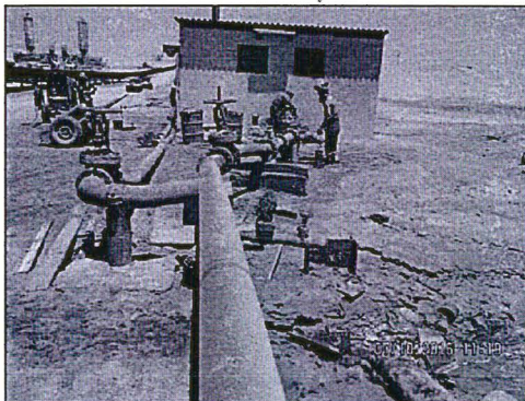
Fotografía N° 25. Vista de la estación de bombeo ubicada adyacente a la poza de agua. COORDENADAS UTM WGS84: 8313792N, 477324E. ZONA 18. Hallazgo N° 3.
