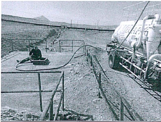
Imagen 01. Succión de agua recuperada en tanque instalado.
