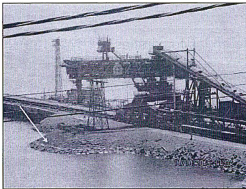
Fotografía N° 140. En la imagen se observa el Gantry, en el talud se puede observar la acumulación de polvo de mineral en contacto con el mar. COORDENADAS UTM WGS84: 8313402N, 474025E. ZONA 18. Hallazgo N° 4, ítem iii).
