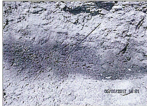
Fotografía N° 67. Vista de la filtraciones ubicado aguas abajo del deposito de relaves Pampa Choclón, se observa el suelo humedo al pie del talud del acantilado.
