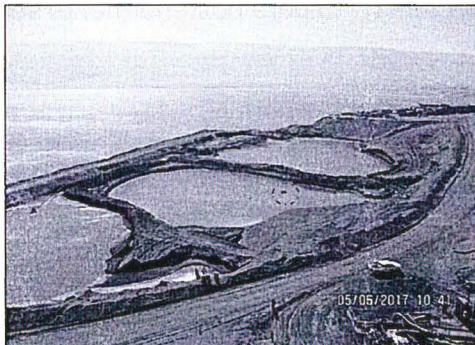
Fotografía N° 72. Vista del sistema de tratamiento de las cochas Bartlett, conformado por tres (03) pozas de sedimentación.
