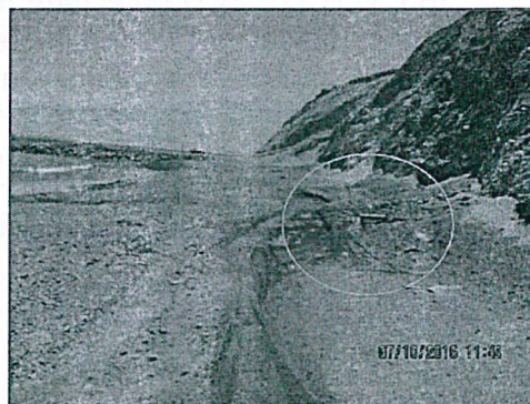
Fotografía N° 31. Zona de filtraciones ubicada al lado oeste de la Relavera Pampa Choclón, en la imagen se observa una de las tuberías encargada de captar las filtraciones. COORDENADAS UTM WGS84: 8313438N, 476179E. ZONA 18. Hallazgo N° 1.
