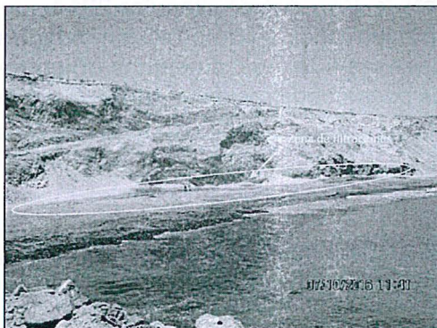
Fotografía N° 30. Zona de filtraciones ubicada al lado oeste de la Relavera Pampa Choclón. Se ubica en el acantilado adyacente al mar teniendo una dimensión aproximada de 700m. COORDENADAS UTM WGS84: 8313525N, 476204E. ZONA 18. Hallazgo N° 1.
