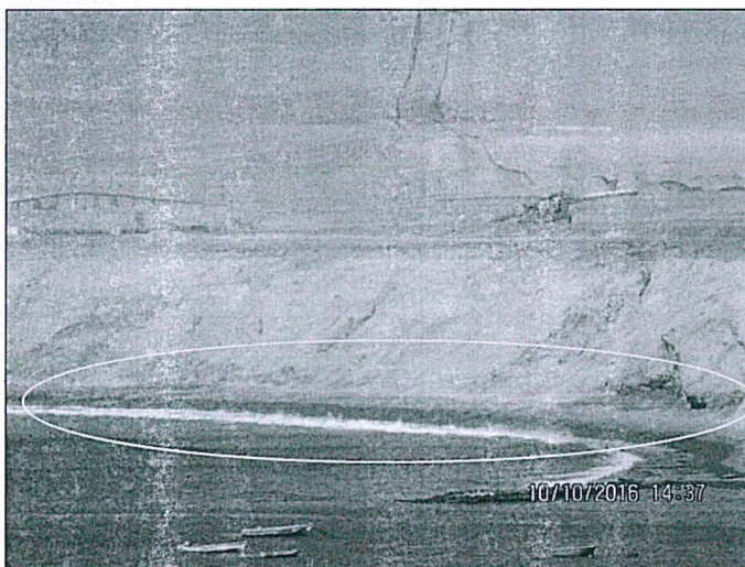
Fotografía N° 37. Zona de filtraciones ubicada al lado oeste de la Relavera Pampa Choclón. Se ubica en el acantilado adyacente al mar teniendo una dimensión aproximada de 700m. COORDENADAS UTM WGS84: 8313525N, 476204E. ZONA 18. Hallazgo N° 1.
