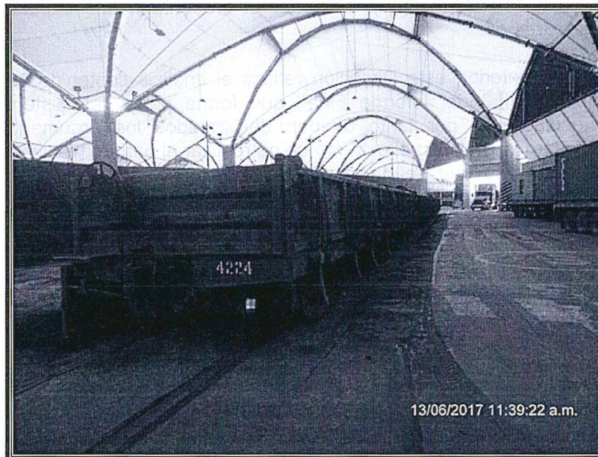
Fotografía N° 16: Área de descarga de concentrados de Zinc. Ubicado en el sector este del almacén Cormin I, adyacente al punto de coordenadas UTM WGS 84 Zona 18L: 268204E, 8667562N. En el piso, cerca al vagón se observa partículas de concentrados que podrían ser arrastrados por las ráfagas de viento que ingresa por la puerta de entrada.
