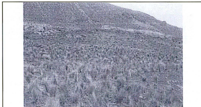
Foto N°6. Muestra el corte de talud remediado, perfilado, nivelado y con presencia de vegetación.
