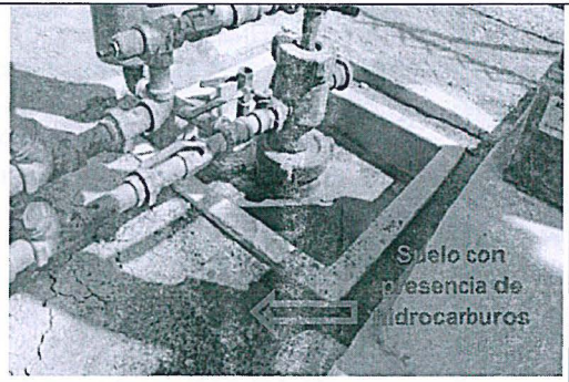
Registro Fotográfico N° 21. Pozo 12688 de la Batería 209 Bronco. En el estándar de producción en el cabezal de pozo se observó una válvula de 1/2" para muestreo que no cerraba y presentaba fuga de hidrocarburos líquidos.
