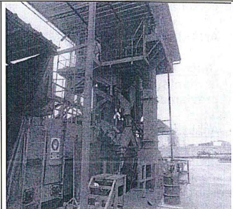
Fotografía tomada durante la Supervisión Especial 2017, en la que se muestra la máquina granalladora automática denominada "granalladora N° 2", la cual se ubica sobre piso asfaltado y bajo techo.
