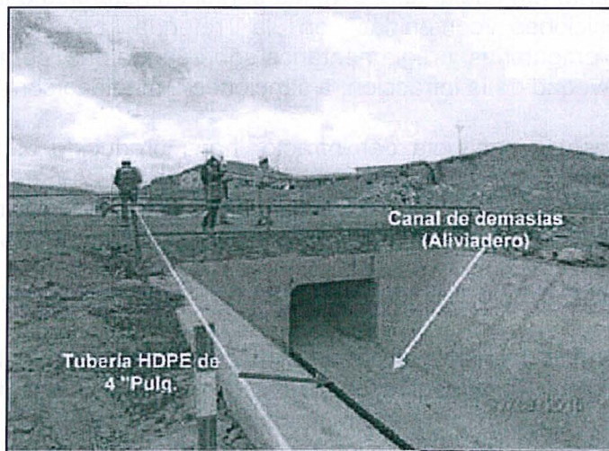
Fotografía 65: En el interior del vertedero de emergencia del depósito de relaves Ocroyoc se observó una tubería de HDPE de 4 pulgadas que conduce el agua del espejo de la relavera Ocroyoc con dirección al río Ragra.
