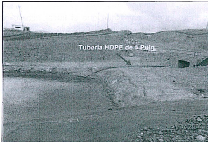
Fotografía 64: Vertedero de emergencia para la conducción del agua del espejo de la relavera Ocroyoc hacia el río Ragra. Se observa el punto de salida de la tubería de HDPE de 4 pulgadas desde el espejo de agua.
