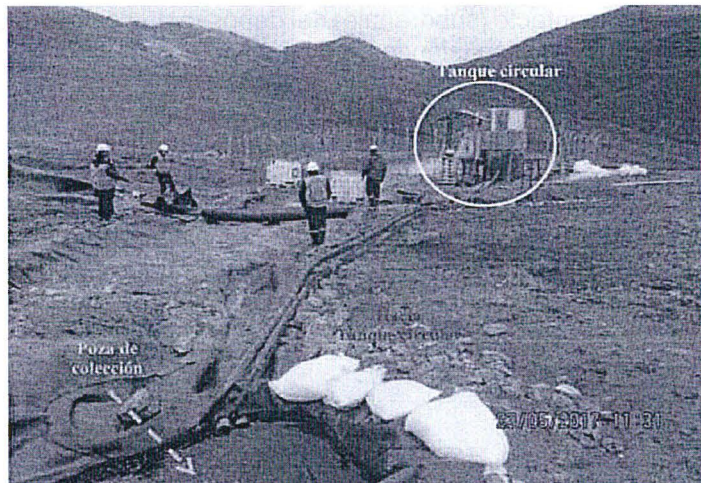
FOTOGRAFIA N° 03.- Sistema de tratamiento de aguas industriales del depósito de desmonte; El agua a tratar era colectada en una poza de colección cubierta con geomembrana para luego ser derivada mediante de tuberías HDPE de 4" de diámetro hacia el tanque circular.
