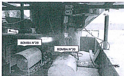
FOTOGRAFIA N°5: VISTA DE UBICACION DE LAS BOMBAS N°29 y N°30 – DEBAJO DEL TANQUE DE RECUPERACION DE AGUA INDUSTRIAL
