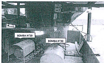
FOTOGRAFIA N°5: VISTA DE UBICACION DE LAS BOMBAS N°29 Y N°30 – DEBAJO DEL TANQUE DE RECUPERACION DE AGUA INDUSTRIAL
