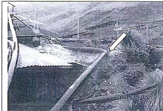
FOTOGRAFIA N°3: LA FLECHA INDICA LA DESCARGA DEL AGUA DE REBOSE DE ESPESADOR HACIA TANQUE DE RECUPERACION DE AGUA INDUSTRIAL.
