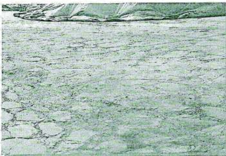
FOTO N° 5: Área en que el piso está en mal estado (hundimientos y agrietado), el cual ya no mantiene la impermeabilización, así mismo, permite la acumulación de restos de concentrado.
