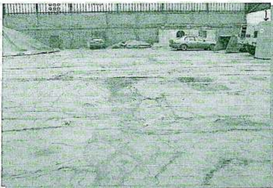
FOTO N° 6: En el área de ampliación, el piso tiene hundimientos y está agrietado, el cual ya no mantiene la impermeabilización, así mismo, permite la acumulación de restos de concentrado.
