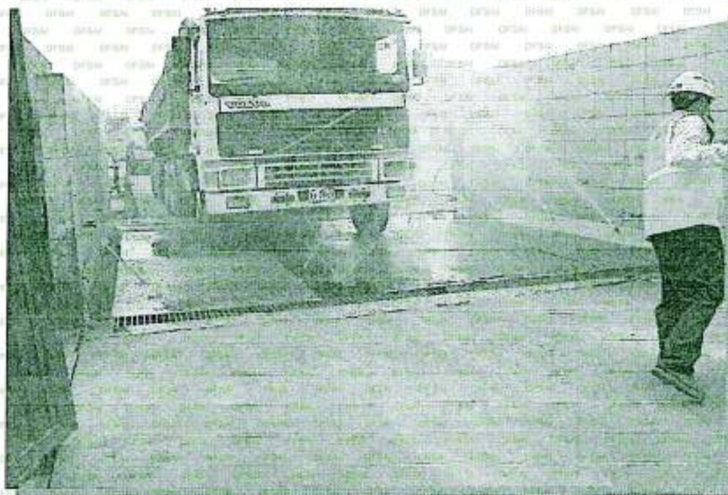
FOTO N° 14: Aspersores del lado izquierdo obstruidos (inoperativo).
