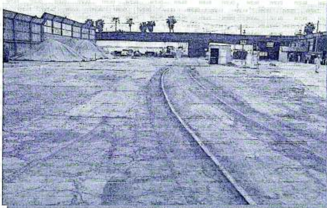
FOTO N° 4: El piso del área cerca al ingreso está en mal estado (hundimiento y agrietamiento), el cual ya no mantiene la impermeabilización, así mismo, permite la acumulación de restos de concentrado.
