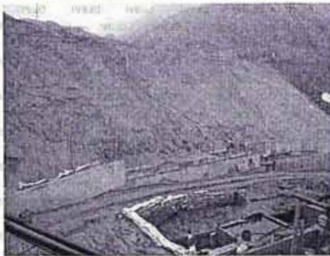
Observación N° 1: Muro de contención de la presa de relaves, inconcluso.
