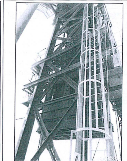
Imagen 10. Zona de Transferencia Fajas CT1 y CT2 (19.09.2018). Coordenadas de ubicación de la toma fotográfica (UTM Zona 17 WGS84): 494414 E - 9359099 N.
