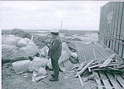
FOTO N° 37: ENTORNO DEL ALMACEN TEMPORAL DE RESIDUOS (ATR). Residuos no peligrosos plásticos mezclados con calaminas plásticas, dispuestos sobre suelo y sin uso de un contenedor en la parte exterior al ATR. Coordenadas UTM (WGS84), Zona 17, 0485052E, 9457070N
