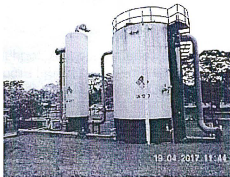
Foto N° 2: Batería 2 – Corrientes. El tanque 1M60S (Batería 2) de techo fijo, recepciona los drenajes de los tanques de almacenamiento de hidrocarburos (agua con petróleo), no cuenta con área estanca y muros de contención (sistema de contención) Coordenadas UTM (WGS84): 0492816E, 9576867N
