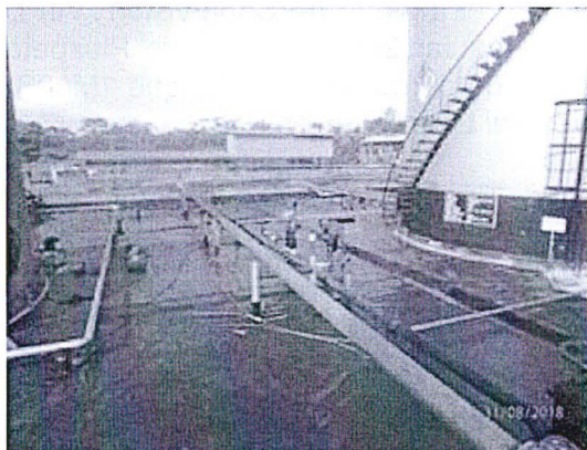
Se observa trabajos de impermeabilización, sin embargo, no se observa que se trate del Tanque 1M60S -detectada durante la Supervisión Regular 2017- y tampoco se evidencia que se haya realizado la impermeabilización a toda el área que comprende el tanque ni que se haya implementado un dique de contención a toda el área, que permita contener derrames ante alguna eventualidad.
