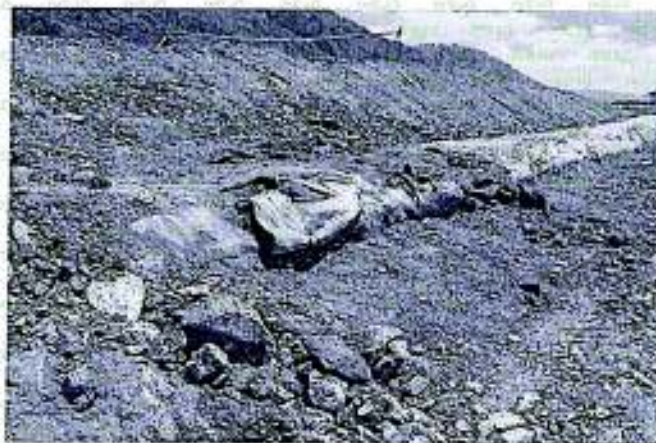
FOTO N° 46.- DEPOSITO DE RELAVE EN EL MURO EXTERIOR CONTIGUO A LA CARRETERA AFIRMADA, SE OBSERVO ROTURAS DE GEOMEMBRANA EN DIFERENTES SECTORES. OBSERVACION N° 17
