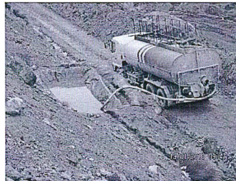
Fotografía N° 30. Se observa a la sistema de agua, el mismo que realiza el trabajo de succión de agua de la poza que capta el ínfimo caudal de la filtración de agua del talud colindante a las pozas de geotextil, para su traslado a uno de los sistemas de tratamiento Andrés o Jessica
