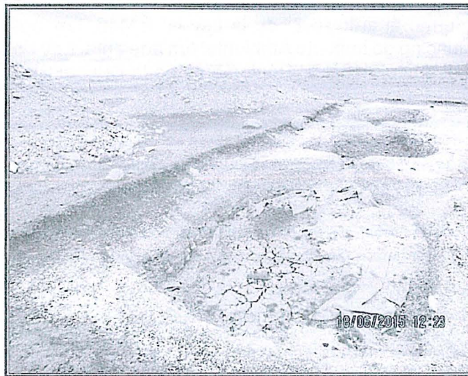
Fotografía N° 97: La fotografía muestra las dimensiones de las pozas de sedimentación y el material de corte extraído en la plataforma 16.
