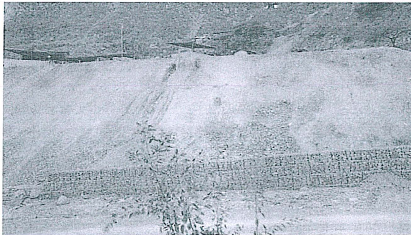
Fotografía N° 266: HALLAZGO N° 3: En el depósito de desmonte Karola, se observó dos bancos de 10 metros y 5 metros de altura respectivamente, cuyo pie del talud colindaba con el cauce de la Quebrada El tingo en una longitud de 70 metros aproximadamente. Coordenadas UTM Datum WGS 84: 9145637 N y 211541 E.
