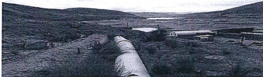
FOTOGRAFÍA N° 31.- Antigua línea de conducción de relave: Ubicada paralela a la línea de conducción de relave, tiene características similares al asbesto, sin uso.
