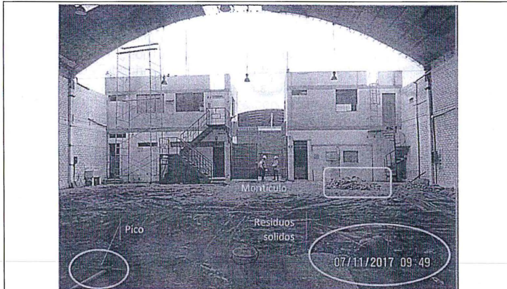
Foto N° 9: Parte de la Planta N° 3, aproximadamente la primera mitad del piso se encuentra removido, el cual correspondería a reparación de suelos, asimismo es notorio la acumulación de montículos y presencia de herramientas de trabajo (pico), residuos sólidos (restos de fierro, botellas plásticas). Los ambientes de los dos bloques (primero y segundo nivel) se encuentran vacías, sin almacenamiento de residuos sólidos, materiales y/o insumos que podrían ser empleados en el proceso productivo de fabricación, importación y comercialización de equipo y accesorios electromecánicos.
