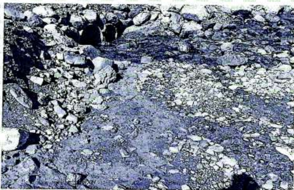
Foto 44 Vertimiento de efluente de depósito de desmontes Palmadera a quebrada del mismo nombre
