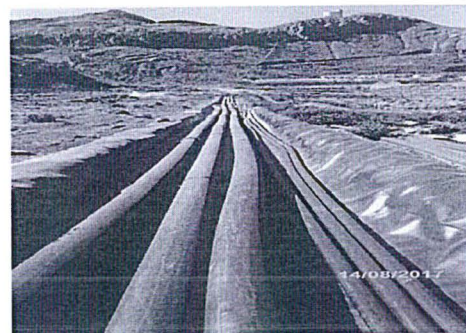
Foto N° 11 En las Coordenadas E 0344103 N 8780826 se observa tubería de relleno hidráulico dentro de canal de contingencia
