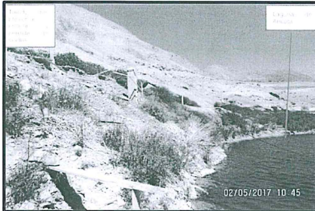
Vista 1L. Vista del área que presenta erosión y pérdida de suelos e inestabilidad de talud
