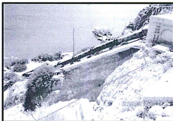
Fotografía N° 1J: Vista del área contigua a la ventana de captación del tercer túnel y losa de concreto para las tuberías de captación, se observó pérdida de suelo e inestabilidad de talud ya que éste presentaba socavamiento, extracción de material (Suelo), dejando en falso y apoyo parcial a la losa de concreto de las tuberías de captación.
