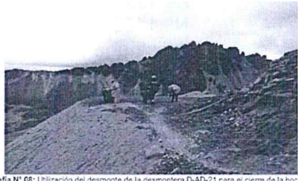
Fotografía N° 08: Utilización del desmonte de la desmontera D-AD-21 para el cierre de la boca AD-19
