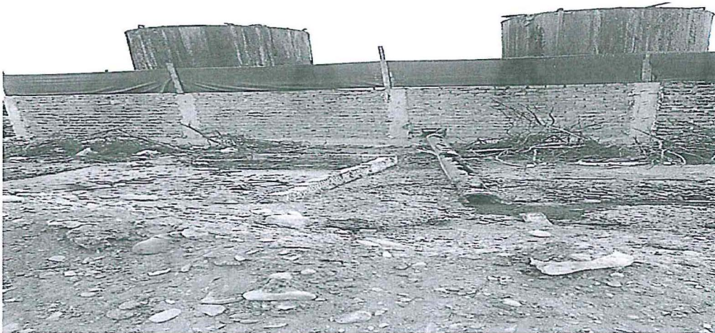
Se observa una tubería para el vertimiento de efluentes industriales, desde el EIPI hacia el exterior. Fuente: Foto N° 8 del Anexo N° 5, Panel Fotográfico del Informe de Supervisión N° 240-2017-OEFA/DS-PES
