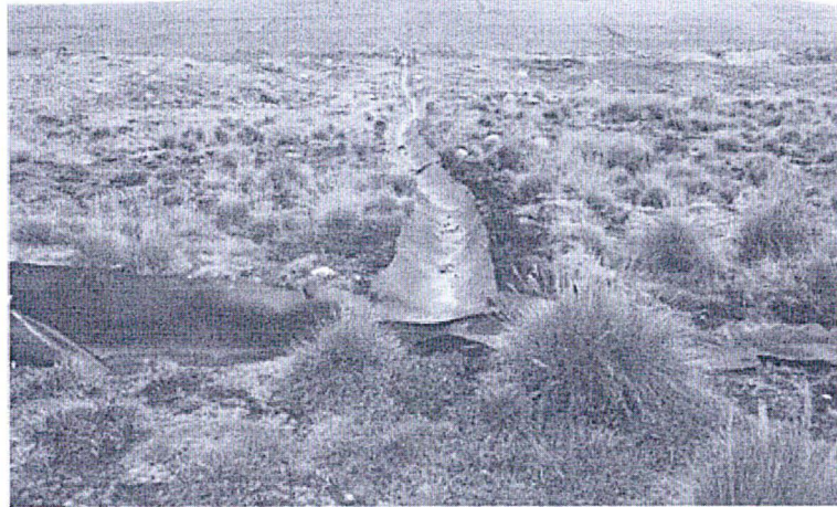
Figura N° 3: Se muestra el estado actual del canal que ingresaba a la poza de sedimentación N°14 canalizado e impermeabilizado hasta el canal de coronación que está a una cota inferior, como se puede observar en la imagen de vista inferior del canal.
